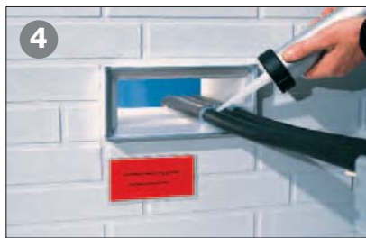
4 Beidseitiges rauchdichtes abspritzen der - Fugen zum Gehäuse - Restöffnungen der Abschlusskappen mit dauerelastischem Dichtstoff
